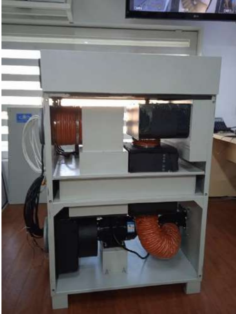
Ilustración 6: Ductos tipo lona flexibles
