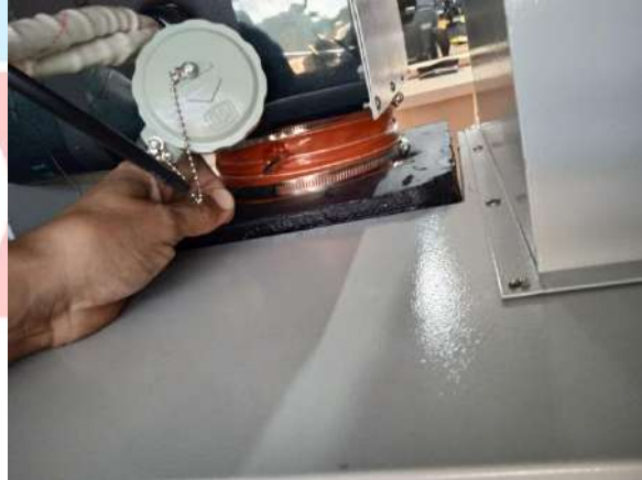
Ilustración 8: Termopar entrada de regeneración
