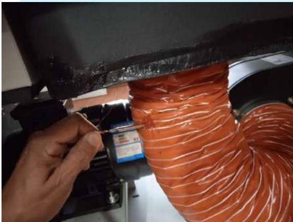
Ilustración 7: Termopar ducto salida de regeneración
