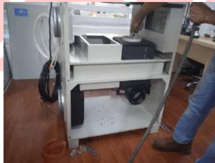
Ilustración 16: limpieza parte de la rueda de regeneración
